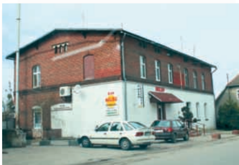
Ryc. 5.125. Wierzchowice. Zmieniona i zniszczona przy okazji elewacja budynku.
