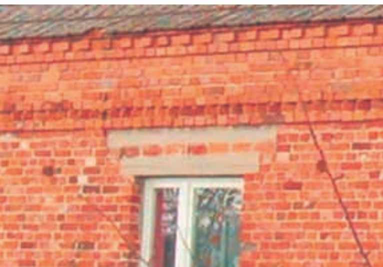
Ryc. 5.59. Obca temu muiowi betonowa belka zastępuje ceglany łuk przy wymianie okna na nowe. Znika subtelność, króluję „prowizorka”.
