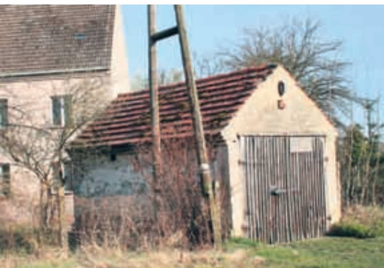
Ryc. 5.149. Niezgoda. Zły stan techniczny remizy.
