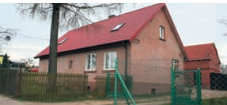
Ryc. 5.48. Czarnogoźdźce. Modernizacji uległy połacie dachu, przy czym mimo ich wysunięcia na szczęście zachowano istniejące gzymsy. Złym posunięciem jest jednak pomalowanie klinkierowego lica na kolor ceglano-podobny. Już niedługo farba zacznie się łuszczyć, zanim właściciel pomaluje resztę spoin na biało. Oczyszczenie prawdopodobnie zabrudzonej elewacji metodą ciśnieniowego piaskowania wraz z renowacją spoin dałoby pozytywny efekt, nawet na kolejne kilkadziesiąt lat.
