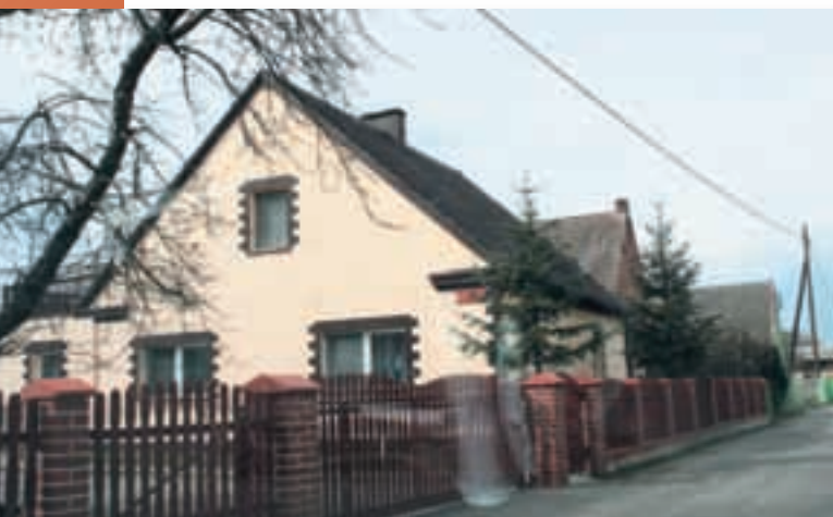
Ryc. 5.54. Właściwie całość tej renowacji przeprowadzono bardzo dobrze. Jednak nie jest to rewaloryzacja. Przeczą jej obce tutejszej tradycji i nie wynikające z konstrukcji otworu okiennego (w tym właśnie nie szczerze), opaski okienne z płytek elewacyjnych.
