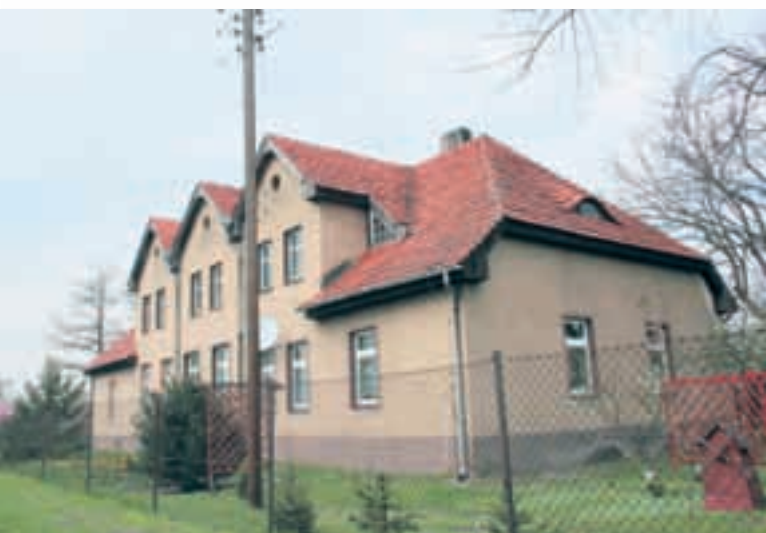
Ryc. 5.99. Potasznia. Dawna szkoła, dziś budynek mieszkalny. Zmiana podziału okien.
