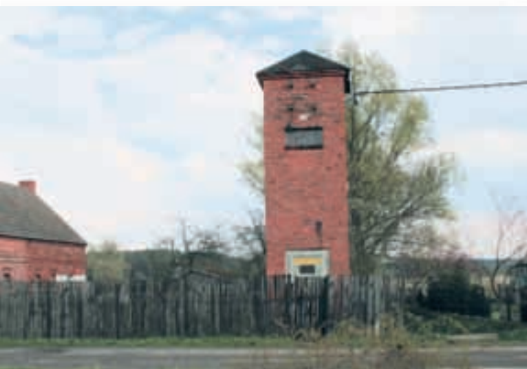
Ryc. 5.159. Świątoszyn. Trafostacja wieżowa.
