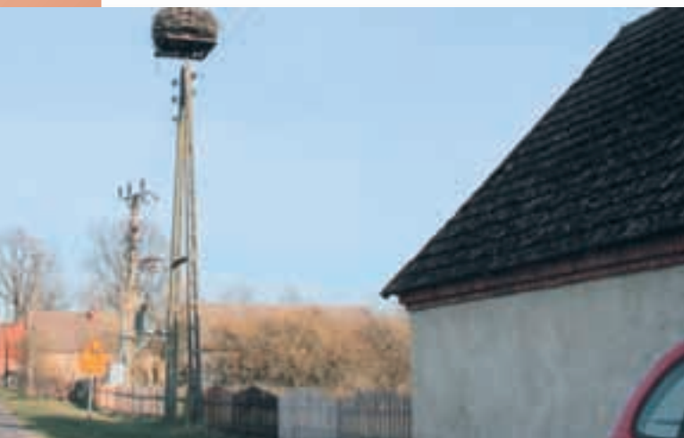
Ryc. 5.162. Wilkowo. W tle trafostacja na słupie żelbetowym.
