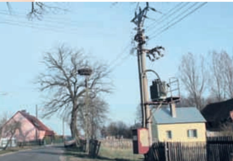
Ryc. 5.161. Współczesna stacja transformatorowa w Grabówce.
